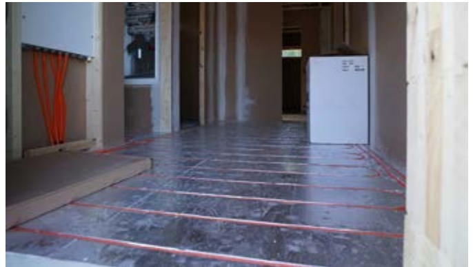
Kuvassa uritettu lämmönluvutuslevy, jossa LL-putkitus
